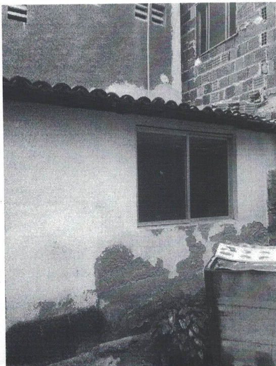
FOTO 05: PAREDES DANIFICADAS EXTERNAS
