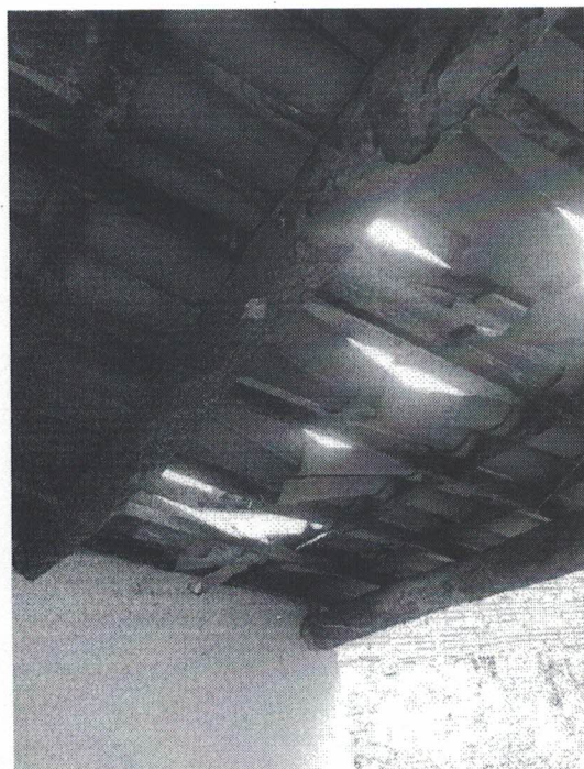
FOTO 06: TELHADO DANIFICADO DO DEPÓSITO
